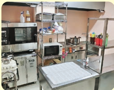
新たに追加された調理設備
