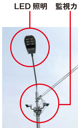
LED照明と監視カメラ(4丁目駐車場)
