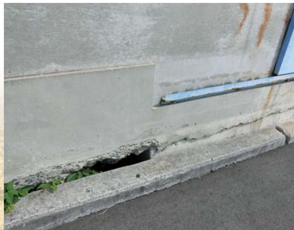
団地周辺は埋立地の為、地盤が弱い
